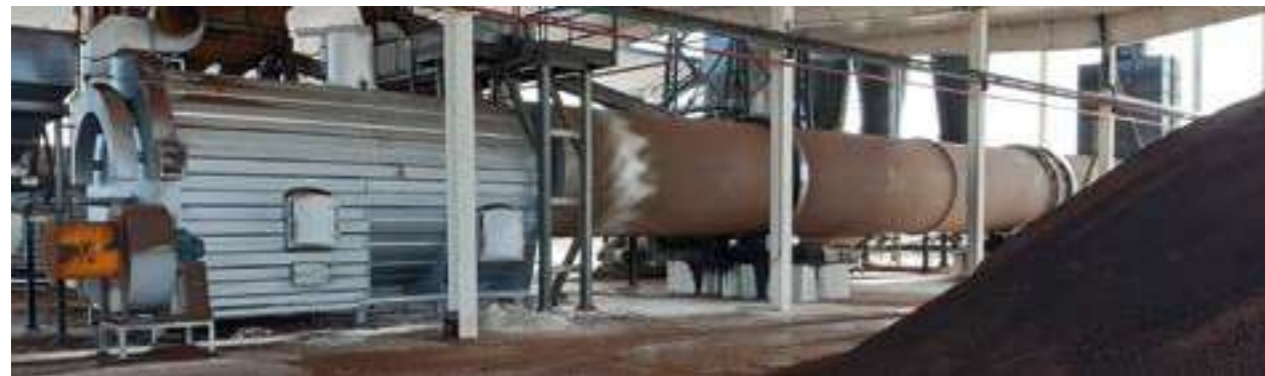
Instalaciones orujera de Osuna
